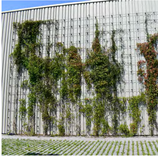
Abb. 60: Bodengebundene Fassadenbegrünungen mit Netzen bzw. Gittern lassen sich theoretisch gut erfassen ... Quelle: BuGG
